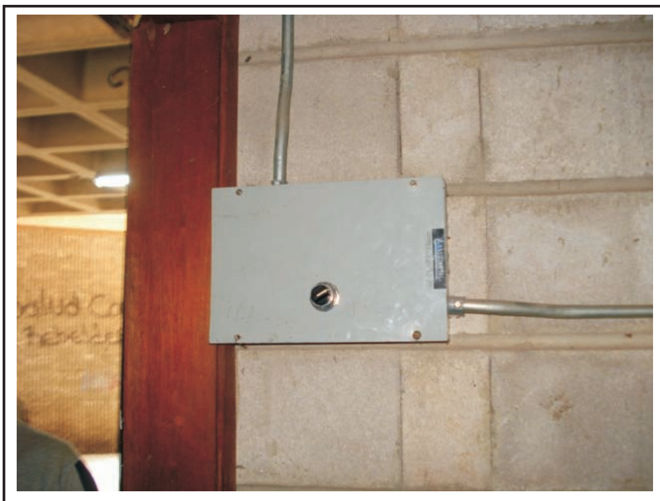
Fig. 4 Temporizador instalado en el edificio 4-A
