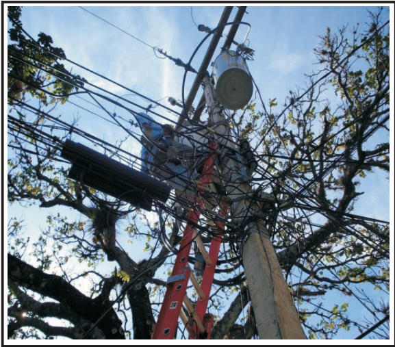
Fig. 3 Transformador de alimentación en el edificio 4-A.
