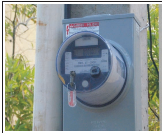
Fig. 1 Analizador de red eléctrica instalado en el edificio 4-A.
