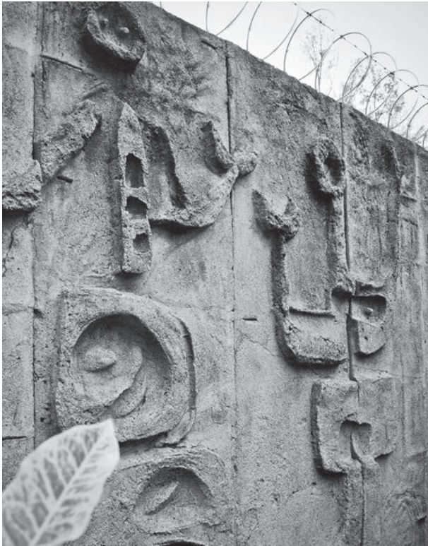
Fig. 7. Detalle de mural interior en la Casa Díaz (1965). Fuente: Guía de arquitectura de El Salvador (inédito).
