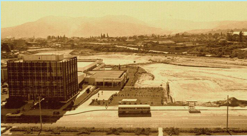
Imagen 5. Trabajos de terracería en centro comercial Metrocentro, 1971. Este desarrollo inmobiliario privado, creó una potente centralidad urbana hacia el norponiente del centro de la capital a inicios de la década de los 70's.
