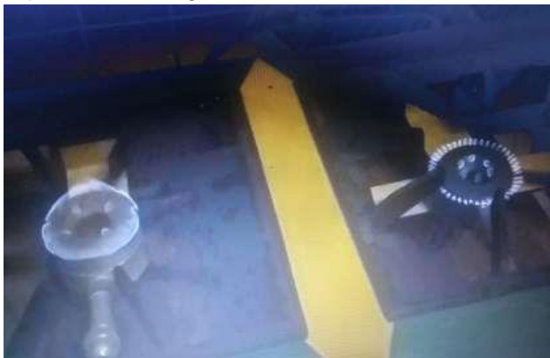
Figura 4: Quemador principal y quemador secundario encendido usando biogás.
