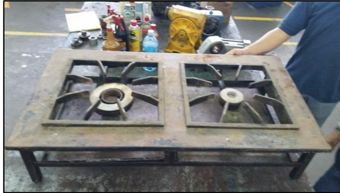
Figura 2. Estado de la cocina industrial de gas licuado de petróleo (GLP).
