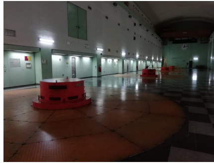
Figura 23: Turbinas de la Hidroeléctrica Francisco Morazán
