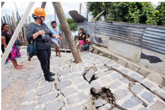
Figura 3: Condiciones de las calles de la zona luego del deslizamiento, presencia de fallas por pérdida de soporte en el suelo.
