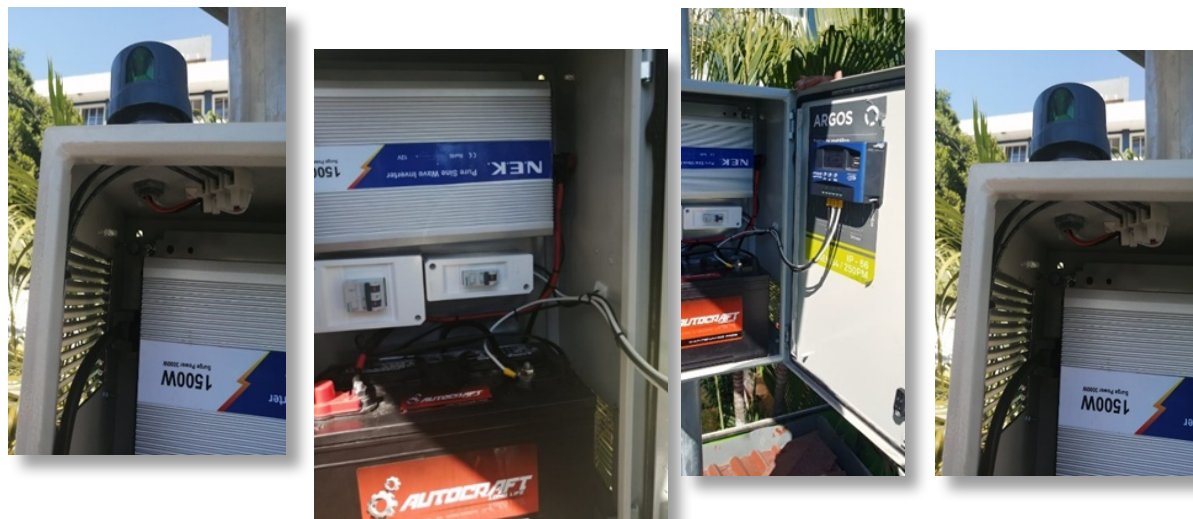
Figura 6. Conexión de la fotocelda, inversor NEK, batería de ciclo profundo y control de carga MPPT. Vista aérea del panel solar. Abajo, la caja marina con las conexiones listas.
